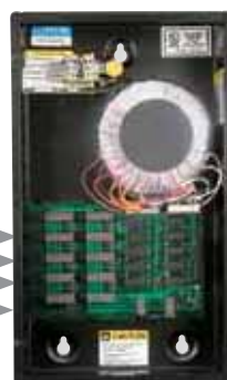
Câblage basse tension de communication et d'alimentation
