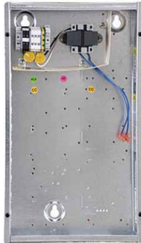
Gabinete de baixa voltagem
